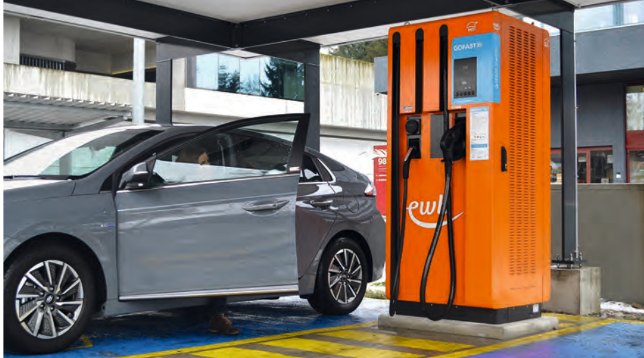
Nebst einem guten Netz an öffentlichen Ladestationen braucht es Lademöglichkeiten am Wohn- und Arbeitsort.
